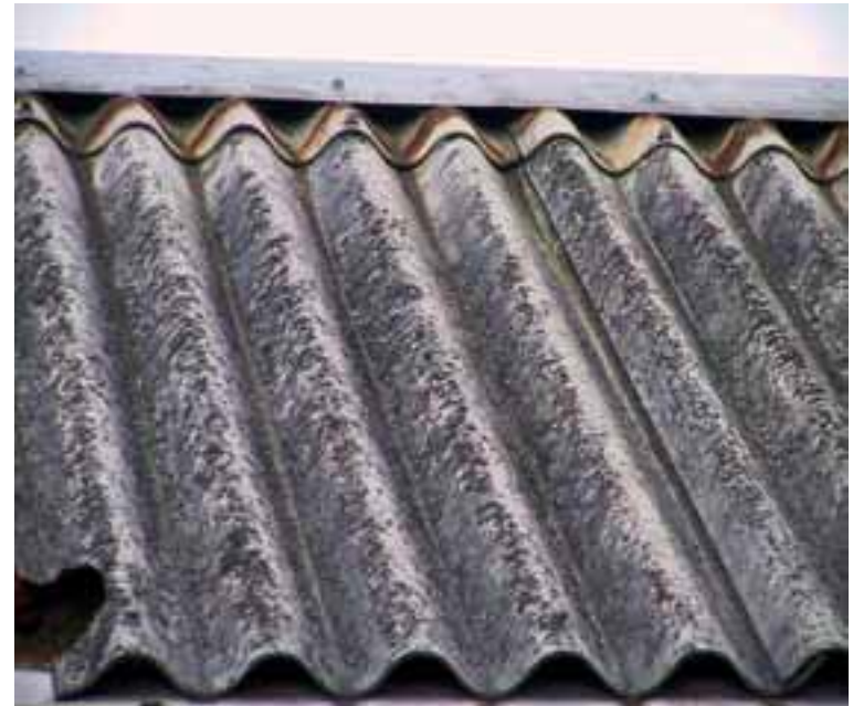
Oberflächlich verwitterte Asbestzementwellplatten
